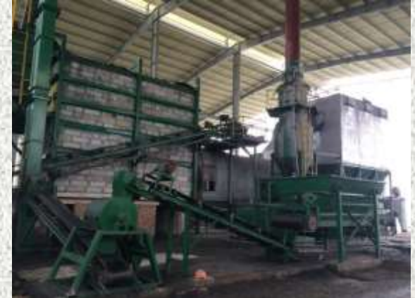
3. Hệ thống lò sấy và cyclone lọc bụi
