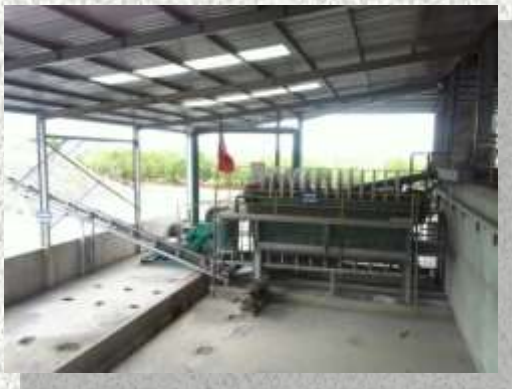
4. Khu vực lọc tro bay
